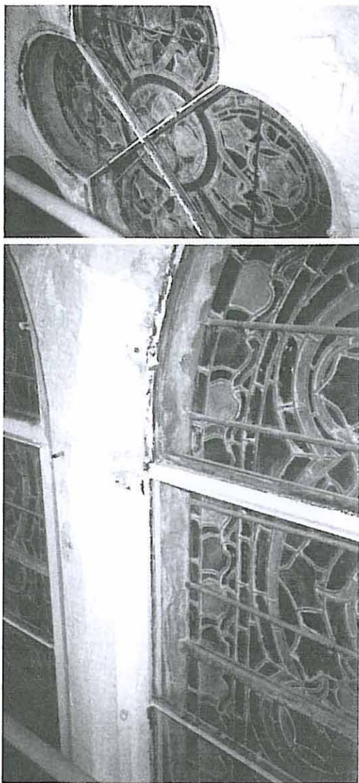
Figura 3 Particolari del processo di ossidazione che ha interessato il telaio in ferro delle controvetrate che ha contribuito alla perdita di funzionalità delle stesse.
