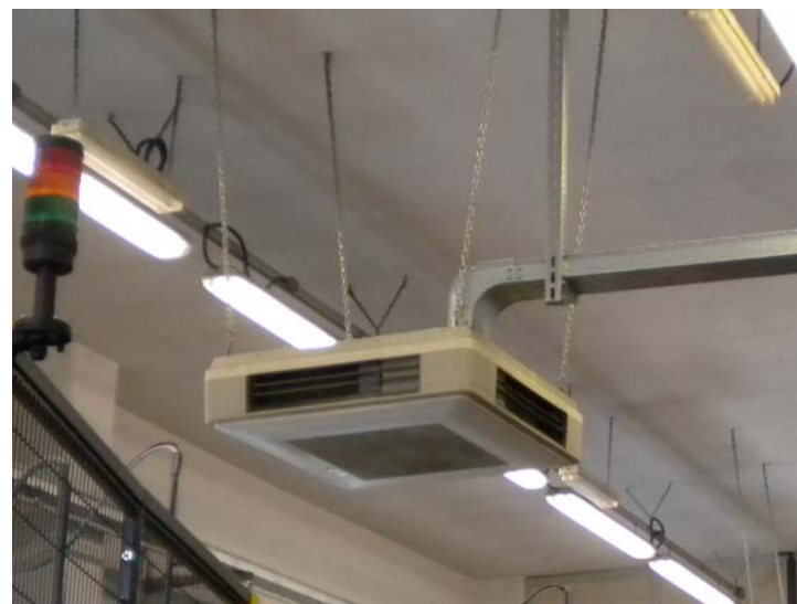
Unità interna del sistema a pompa di calore installata nel reparto elettroerosioni
