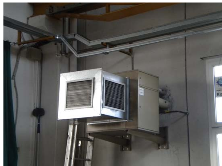
I generatori d'aria calda utilizzati per riscaldare l'opificio
